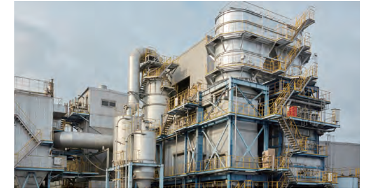
ロータリーキルン&ストーカ炉 能力：93.6t/日、熱回収あり、 発電出力：270kW（タービン出力 520kW）
