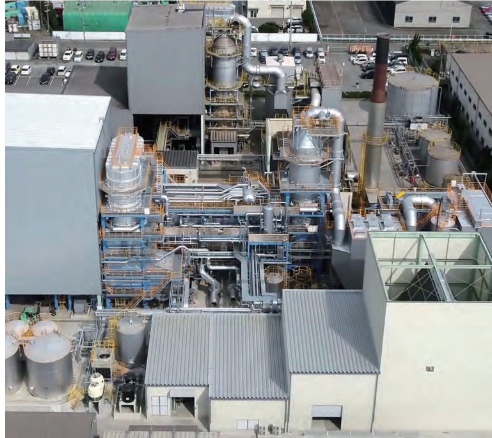
特殊階段式ストーカ炉 能力：93.6t/日 発電出力：1,900kW 熱回収率 22.4%
