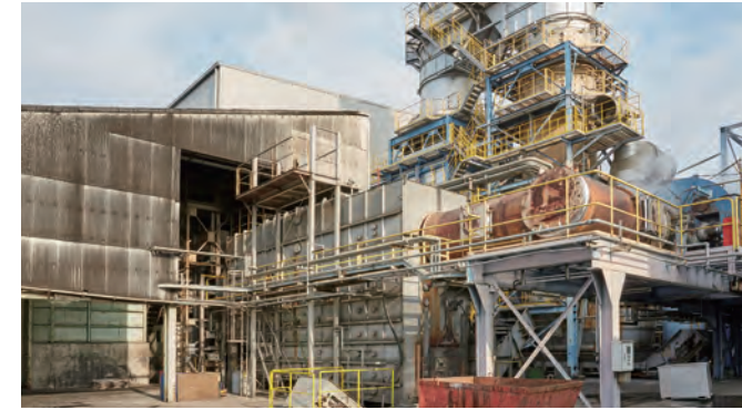
多段式焼却炉 能力：72t/日
